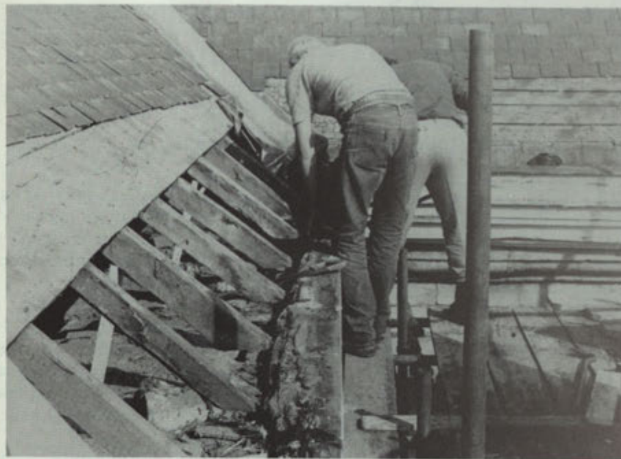
Aangetast hout van het dakwerk van de kerk van Gronsveld.
